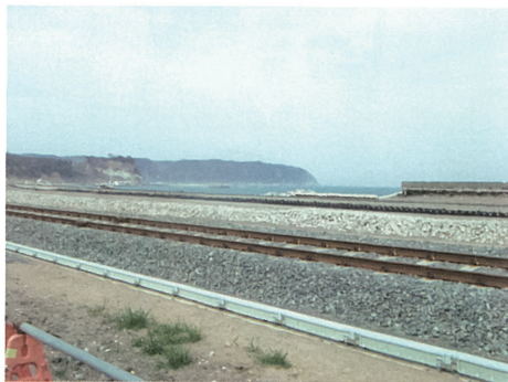
⑦平成24年3月11日大津波で決壊した堤防（岩手県九戸郡野田村）平成24年5月2日
